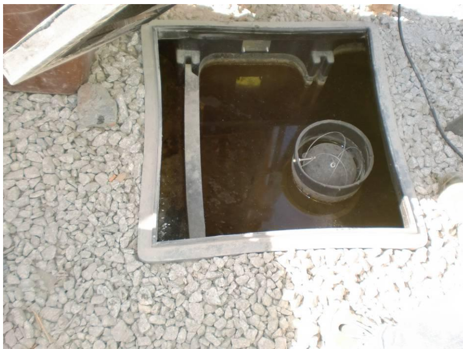
Separador de Hidrocarbonetos - Estaleiro Industrial
