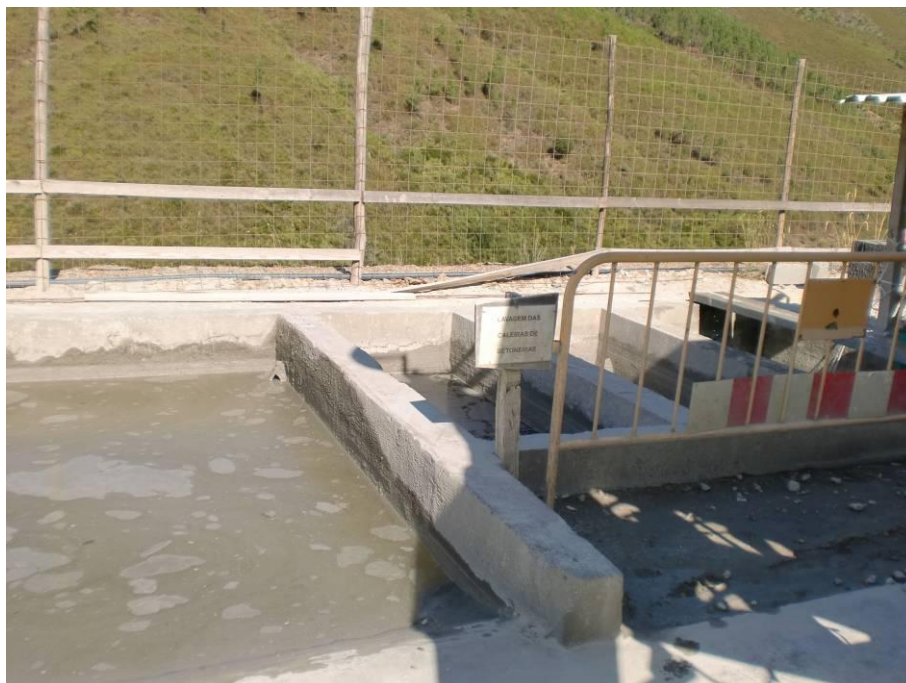
Bacias Decantação - Central de Betão
