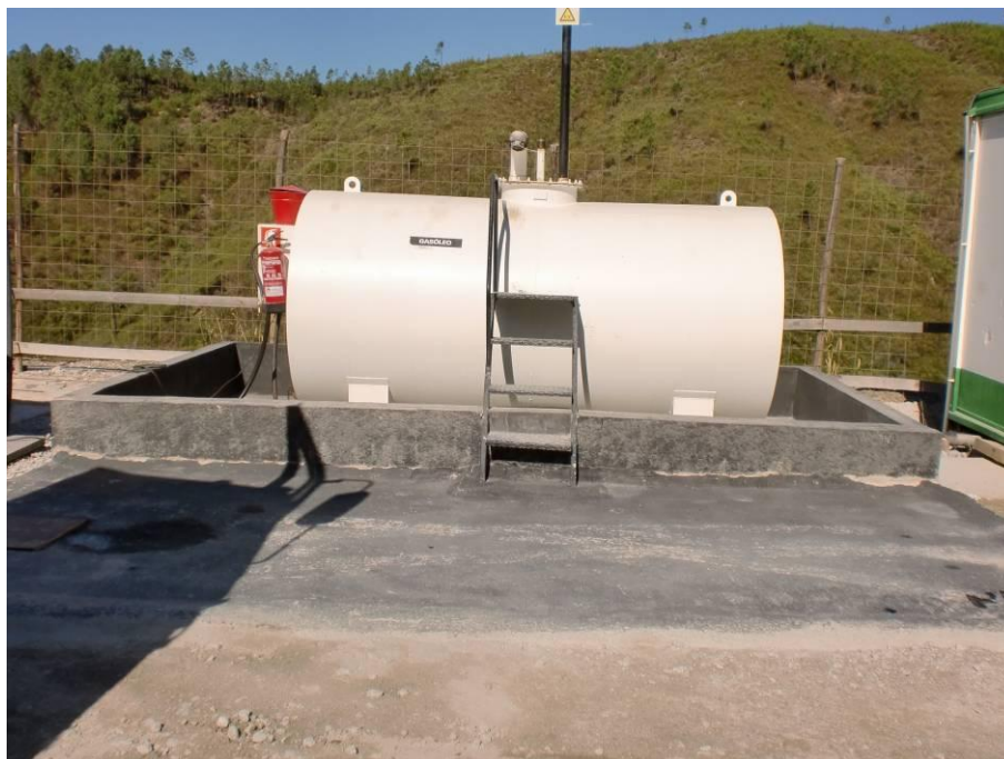
Depósito de Combustível
