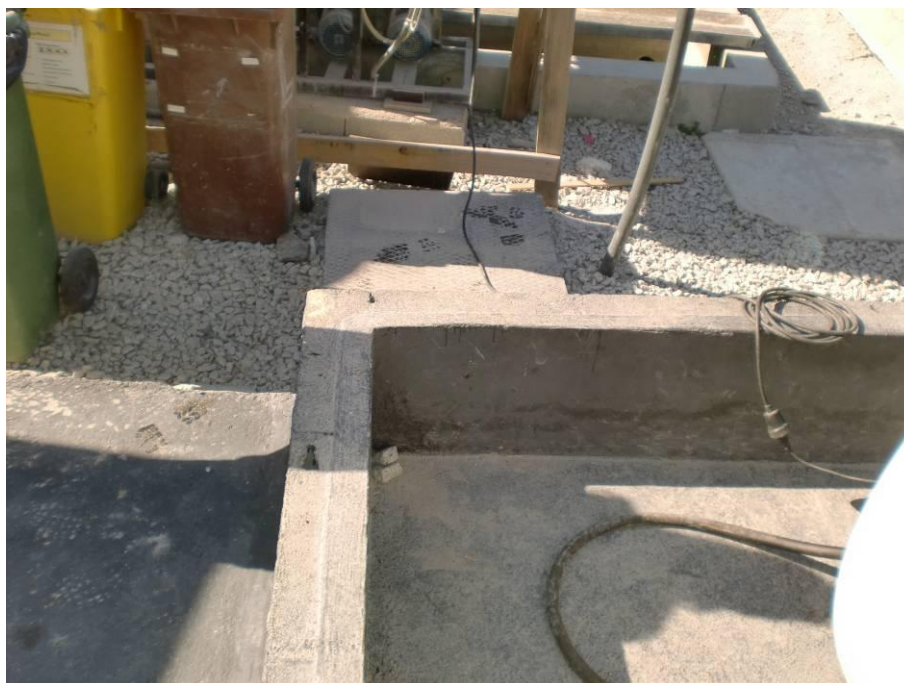
Ligação do Depósito de Combustível ao Seprador Hidrocarbonetos
